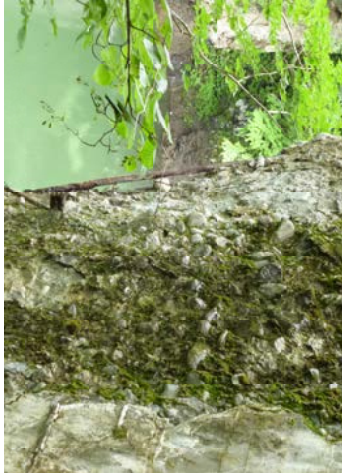
第三橋梁の鉄筋の露出
