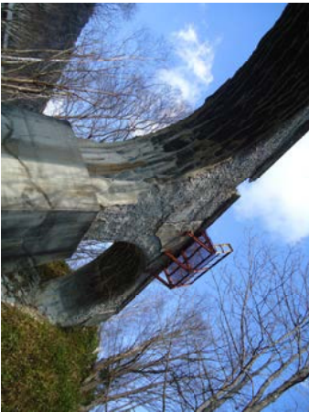
第五橋梁のコンクリートの剥落
