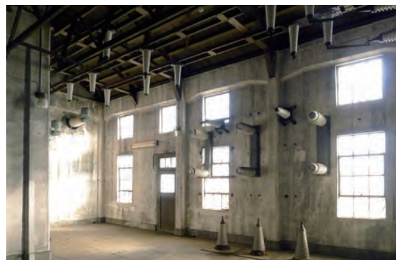
変電所の内部 大空間が広がっている
