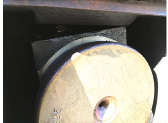
軸受けがずれており修正が必要でした
