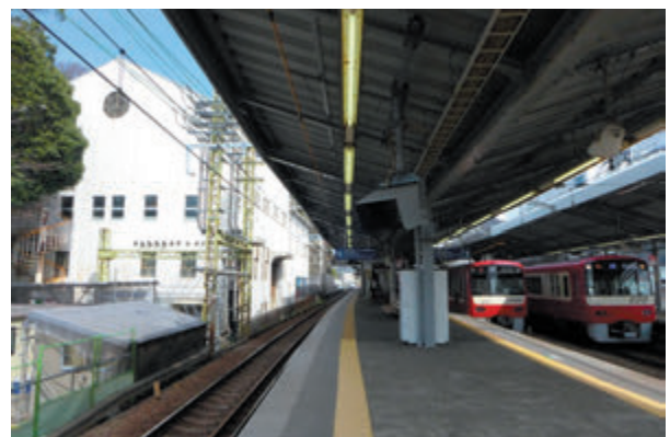
昭和4年(1929)建造の瀬戸変電所
