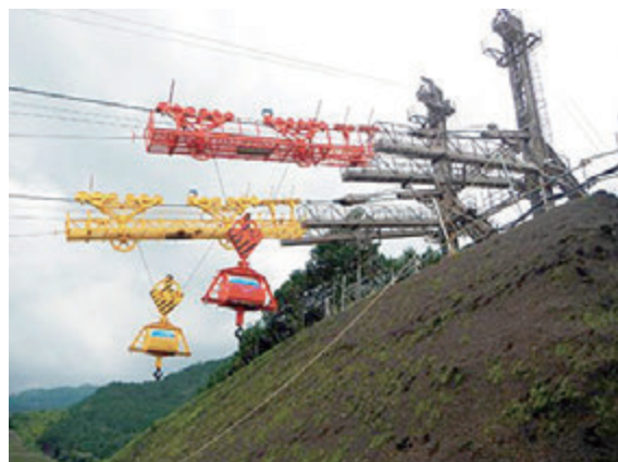
建設工事用索道
